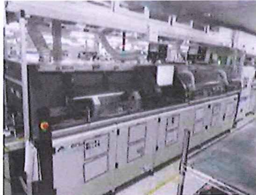
更换后的选择性波峰炉
