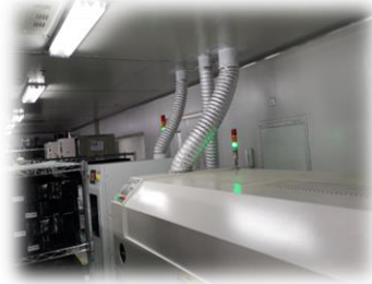
回流焊废气排放管
