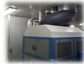
老化柜排气管
